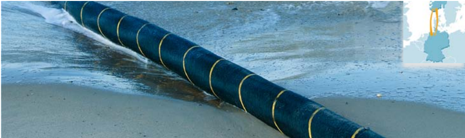
Die Energiemärkte Norwegens und Deutschlands sollen zukünftig über 600 km lange Erdkabel versorgt werden.
